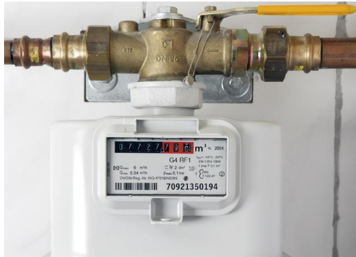
Contador de gas ciudad
