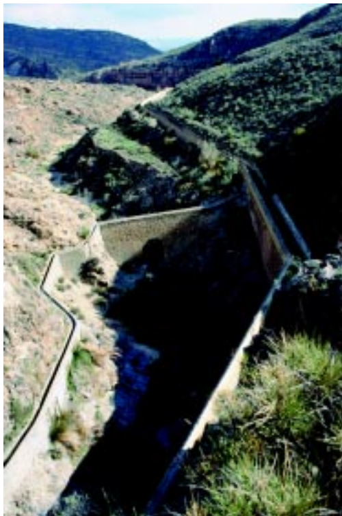
Canalización de salida.
